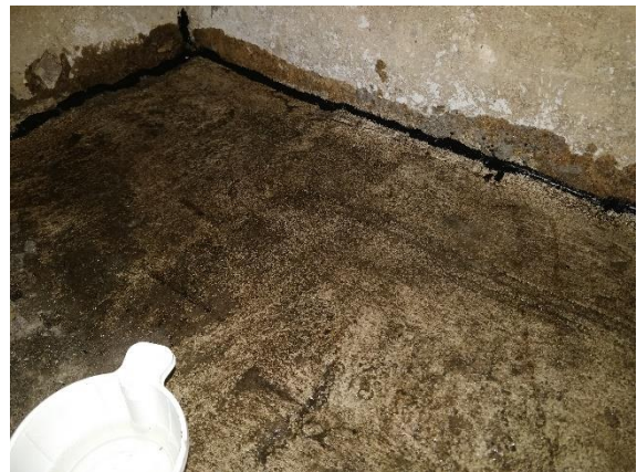
#6 Krybekælder - større revner tættes med egnet fugemasse.
