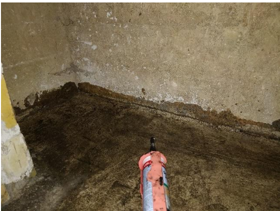
#5 Krybekælder - større revner tættes med egnet fugemasse.
